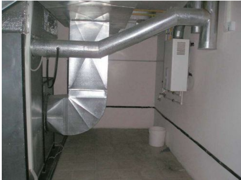
Рисунок 1 – Вентиляционное оборудование на чердаке здания
