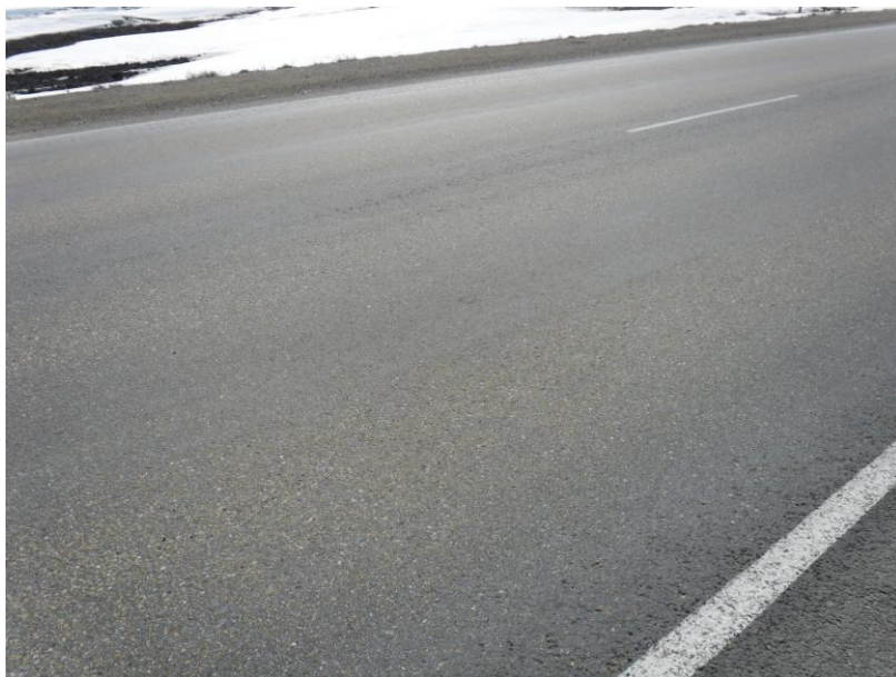
Рисунок 2 – Состояние асфальтобетонного покрытия после двухлетней эксплуатации
