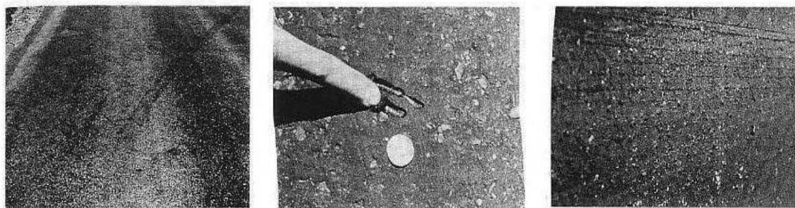
а) легкое повреждение б) повреждение средней тяжести в) тяжелое повреждение
