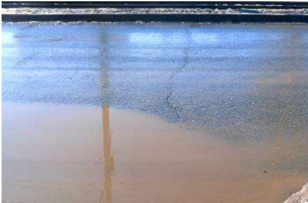
Рисунок 2 – Застой воды в районе ул. Исакова
