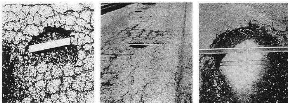
а) легкое повреждение б) повреждение средней тяжести в) тяжелое повреждение
