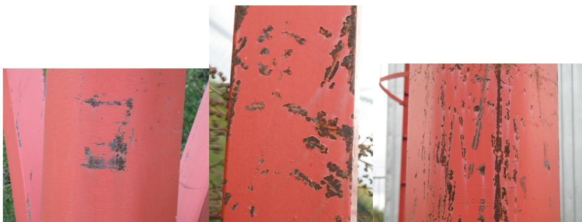
Рисунок 1 - Следы механических повреждений антикоррозийного покрытия поясов башни Н=70 м, БС № 41669 «Старотырышкино»
