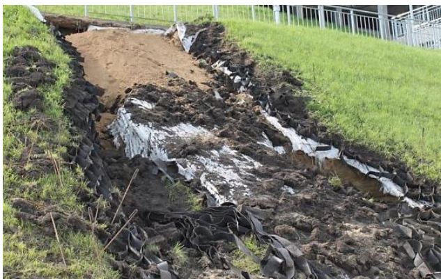
Рисунок 1 – Оползень на склоне Нагорного парка
