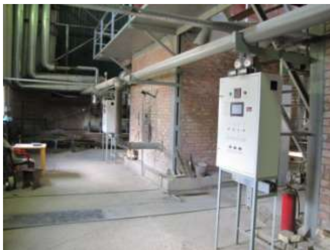
Рисунок 1 – Котлы КЕ-10-1,4 с кирпичными циклонным предтопками
