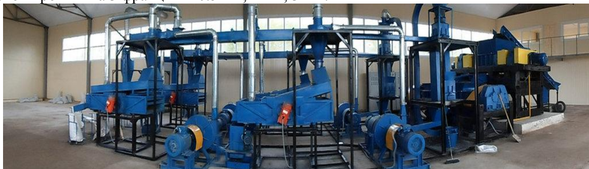
Рисунок 1 – Линия по переработке шин
